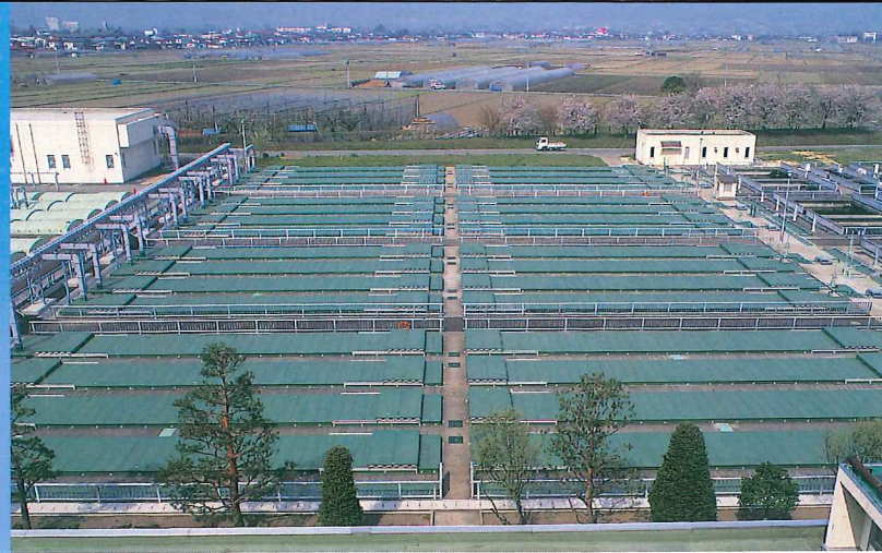
下水処理場曝気槽蓋
