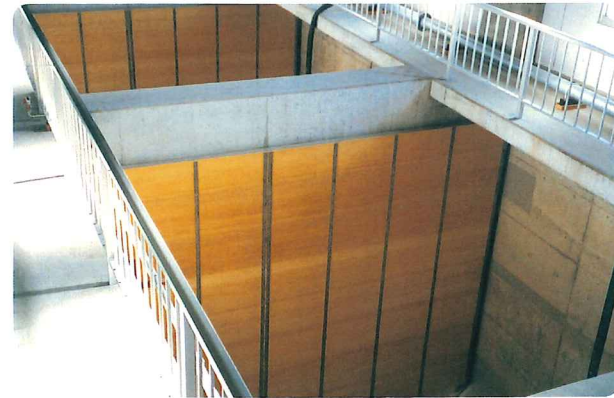
曝気槽仕切板
